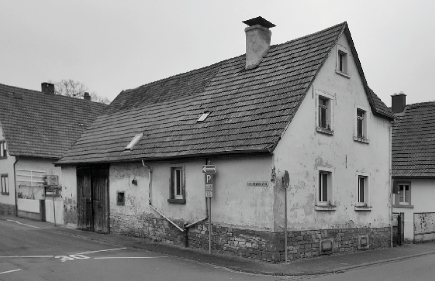
Gebäude in der Haslocher Straße mit Sanierungsbedarf
